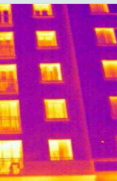
Mur extérieur isolé Absence de déperditions de chaleur après isolation des murs par l'extérieur
