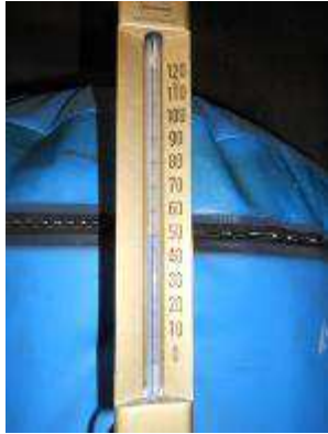
Photo du thermomètre du ballon de stockage
