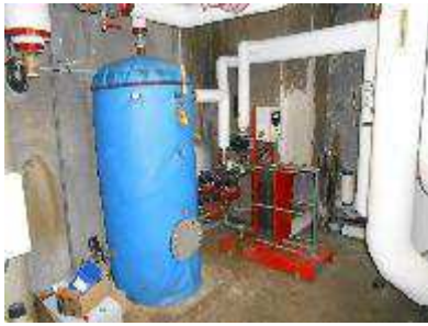
Photo du préparateur et du ballon de stockage
