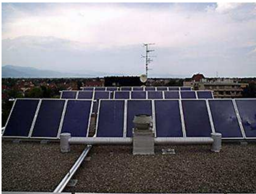
Capteurs solaires thermiques
