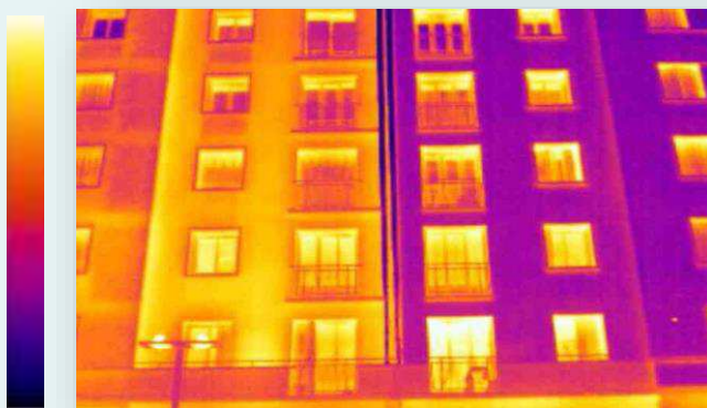
Mur extérieur non isolé Déperditions de chaleur Jaune = chaud de l'intérieur qui sort à l'extérieur
