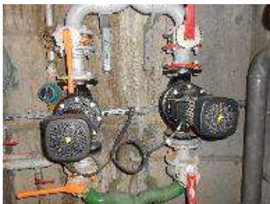
Photo des pompes de bouclage
