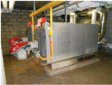
Photo des chaudières
