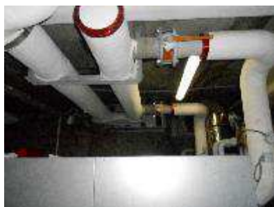
Photo du réseau
