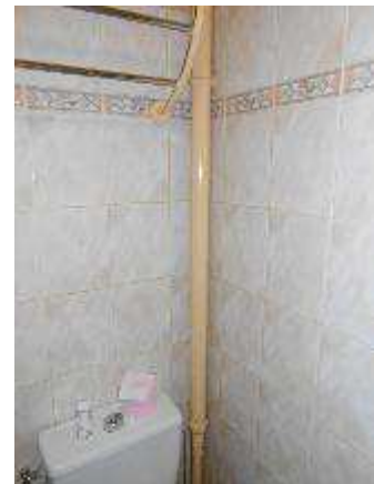
Réseau de chauffage passant dans un WC
