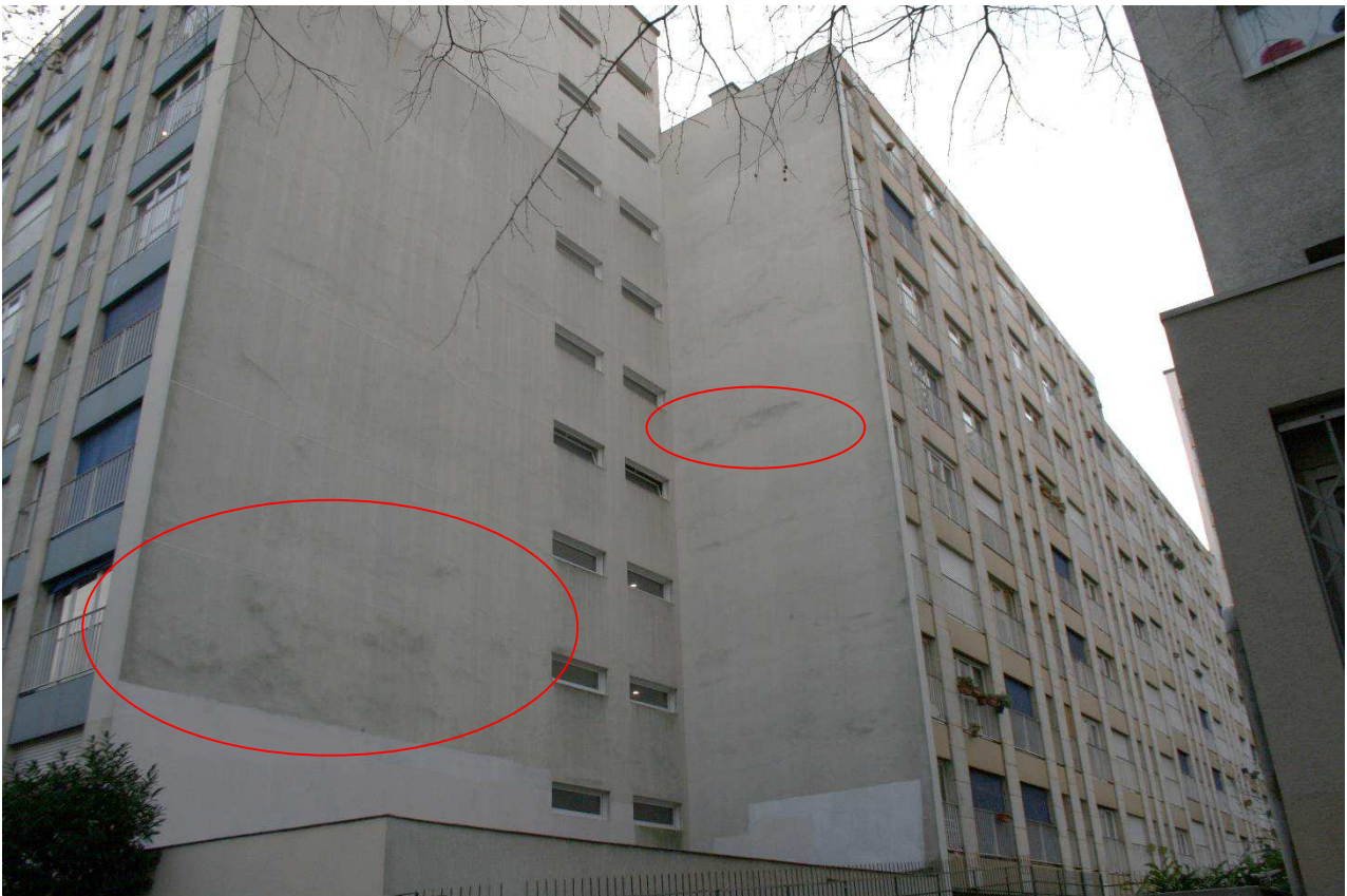
Traces d'encrassement des façades.
