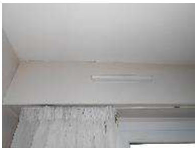
Photo d'une entrée d'air
