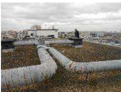
Photo des gaines de ventilation en toiture
