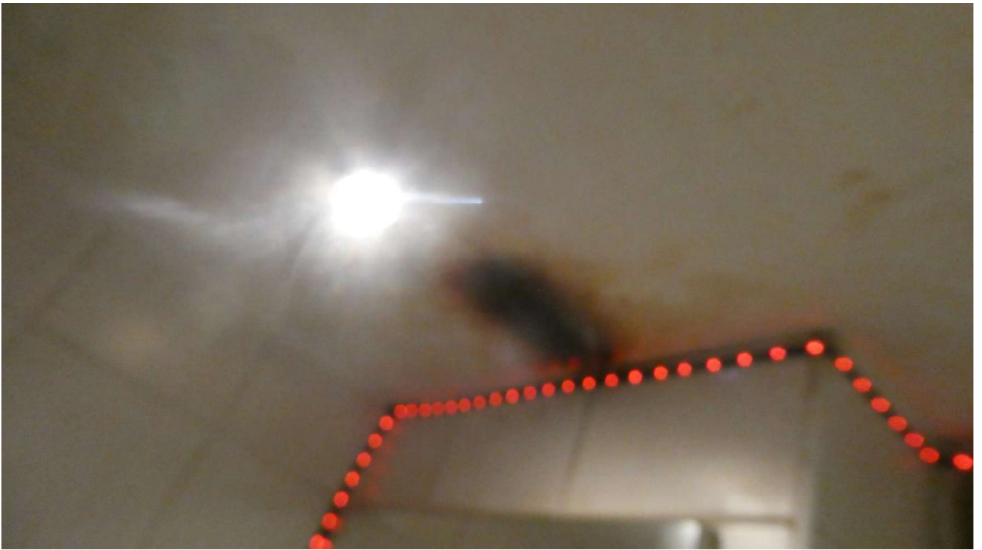
Courette côté salle de douches :
